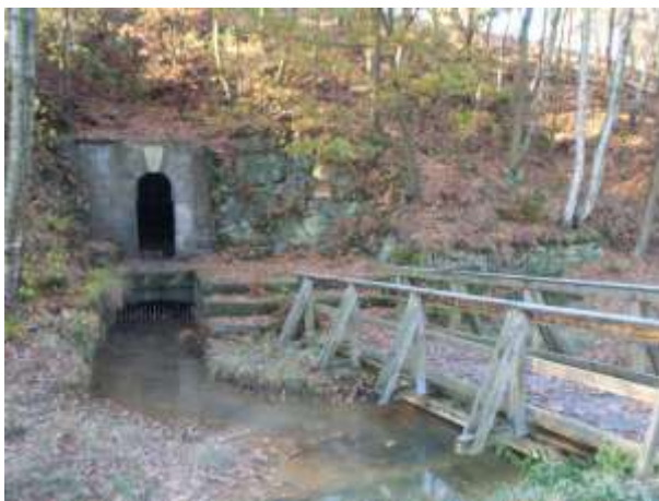
Abbildung 19: Mundloch des HSU mit Grubenwasseraustritt.
